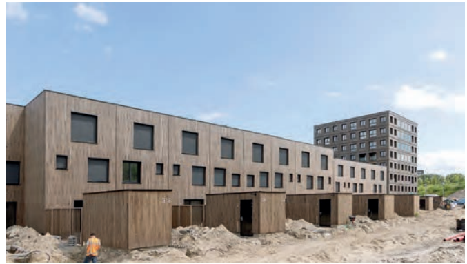
De bamboe gevelbekleding van de rijtjeswoningen is op locatie aangebracht met een kliksysteem; bij de woontoren is die al voorgemonteerd in de fabriek.
