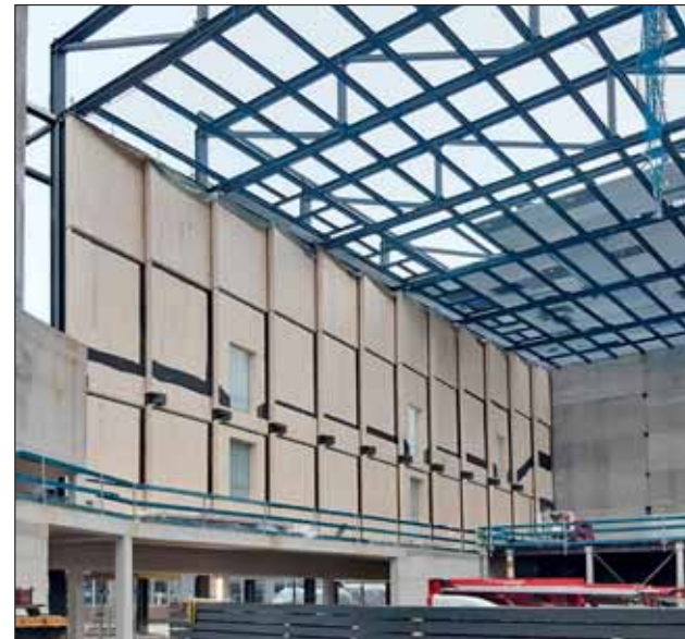
Die großformatigen Brettsperrholz-Wandelemente wurden per Kran durch das offene Dach eingefädelt und an der Stahlkonstruktion der Halle befestigt. Foto: Züblin Timber
