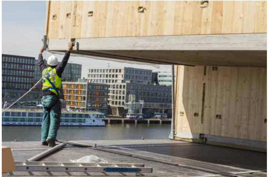
Bild 6: Exaktes Platzieren der Raum-Module mit Hilfe von Stahldornen (unteres Modul) und Löchern (oberes Modul), die beim Ablassen ineinander greifen. (Bildquelle: Derix-Gruppe)
