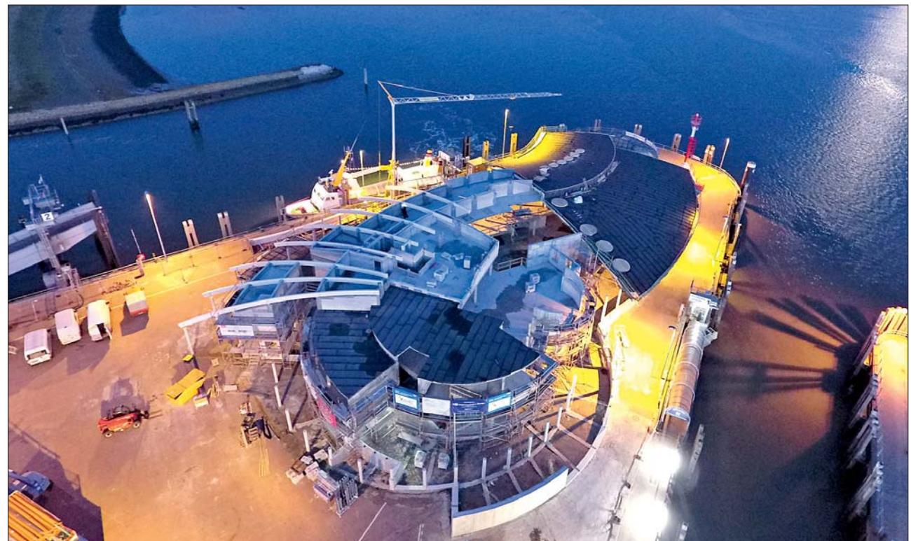
Die Anlieferung der Elemente und der Aufbau des Terminals musste den Gezeiten folgend bis in die Abendstunden ausgedehnt werden. Foto: Dennis Groß Photography
