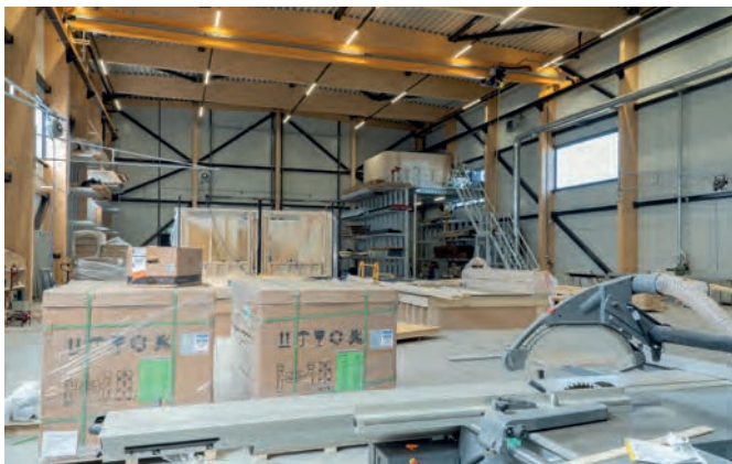
De constructie van de hal van gelamineerde houten kolommen en liggers is versterkt met stalen schoren.
